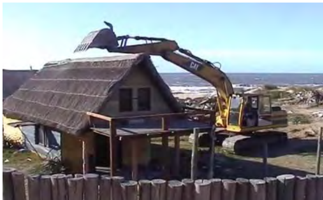
Demolición de casas construidas en terrenos fiscales, 2011 (Punta del Diablo). Fuente: Sistema Nacional de Televisión Uruguay.
